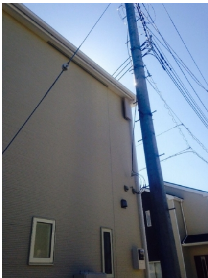
高崎市上波榎町 壁面取付 デザインアンテナ工事
