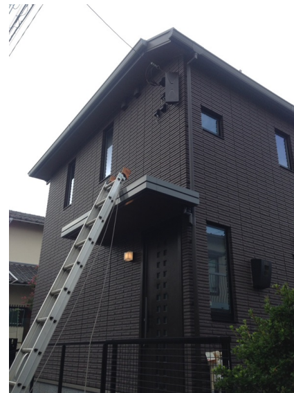
横浜市旭区笹野台 ブースター電源部 ブースタ ー本体
