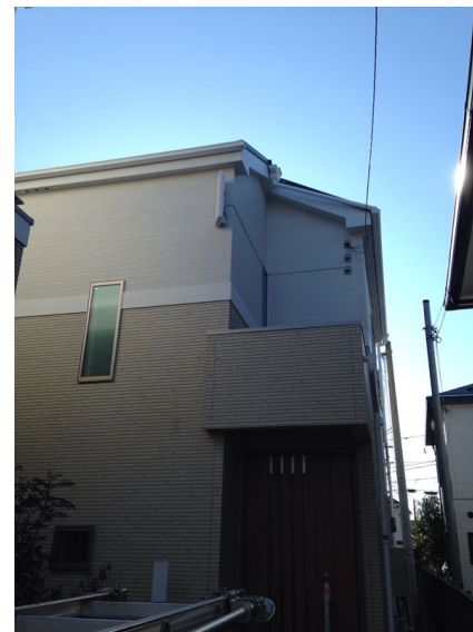
大和市林間 サンケイホーム様物件 ブースター本体 ブースター電源部
