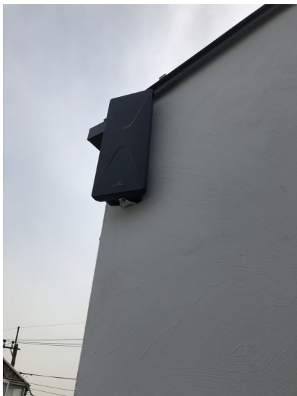
目黒区大岡山 デザインアンテナの壁面設置
