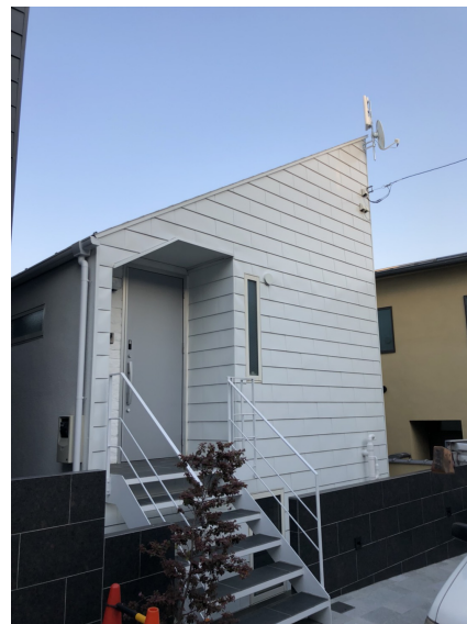
目黒区柿の木坂 デザインアンテナとBS/CSアンテナの壁面設置
