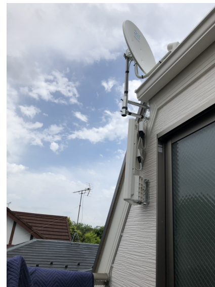
目黒区碑文谷 デザインアンテナとBS/CSアンテナの壁面設置
