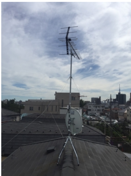
葛飾区堀切 地デジアンテナとBSアンテナ屋根上工事
