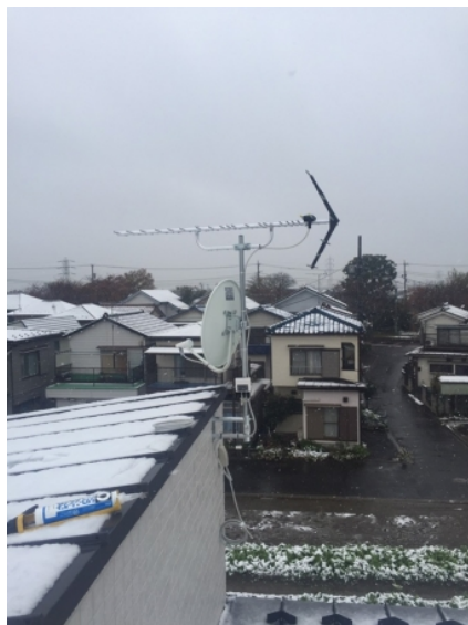
葛飾区東水元 壁面取付 地デジアンテナとBSアンテナ工事
