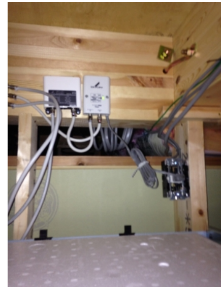
川口市道合 ブースター電源部 ブースター本体
