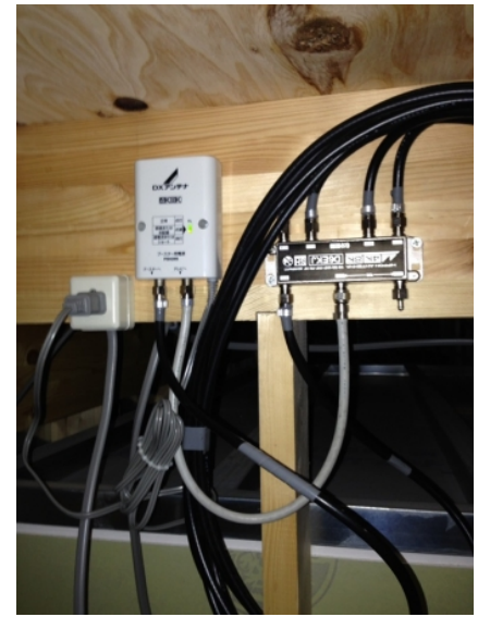
川口市安行原 ブースター電源部 6分配器
