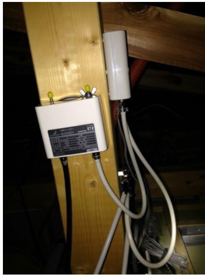
川口市石神 永大様物件 ブースター電源部 ブースター本体
