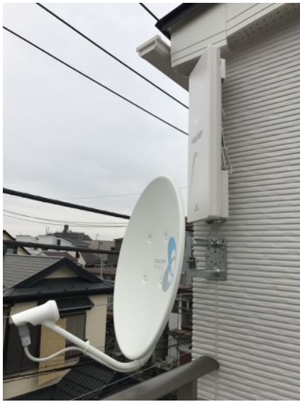
川口市相原町 ワンズOWNハウス様物件 壁面取付 デザインアンテナとBSアンテナ工事
