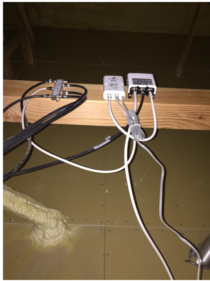
川口市西立野 6分配器 ブースター本体 ブースター電源部
