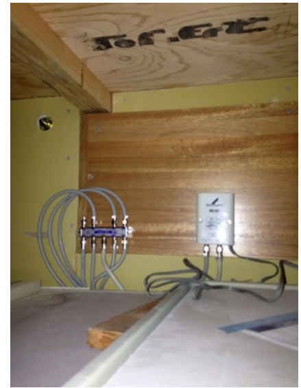
川口市峯 ブースター電源部 8分配器
