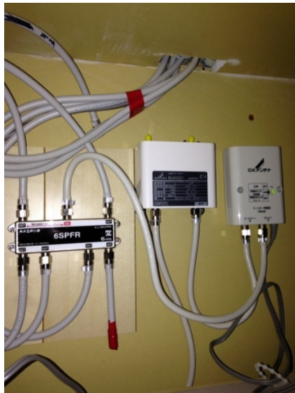
川口市峯 ブースター電源部 ブースター本体 6分配器
