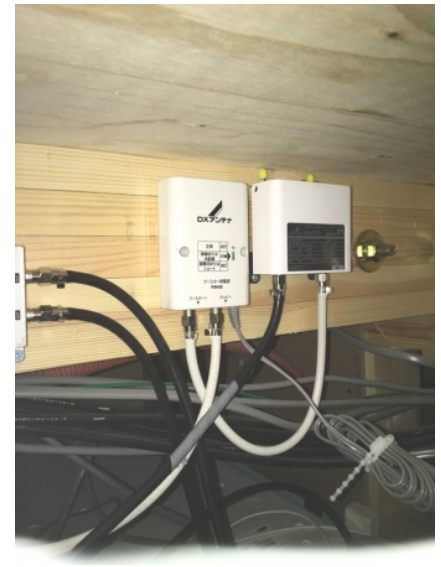
川口市上青木 ブースター電源部 ブースター本体
