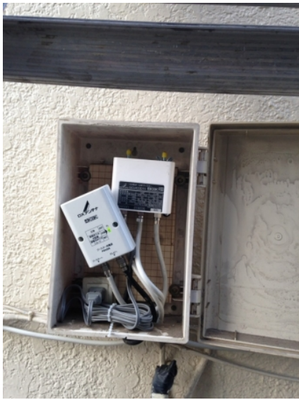
川口市西青木 ブースター電源部 ブースター本体
